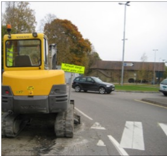
Manglende hensyn til de myke trafikanter.
