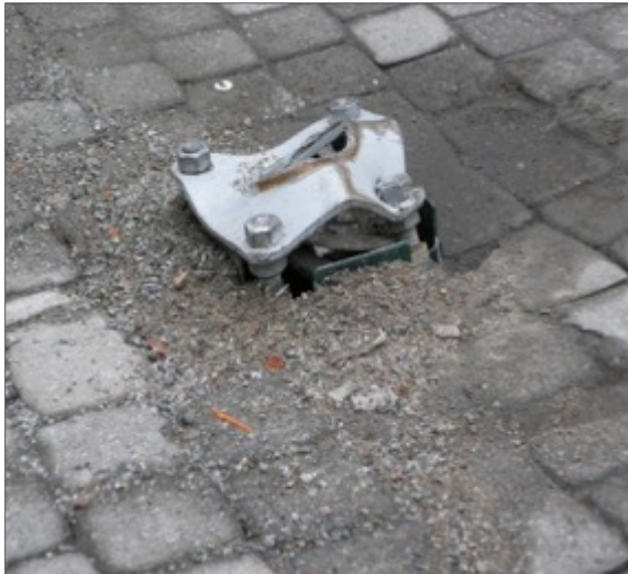
Manglende sikring/varsling av mastefundament medfører fare for å snuble.
