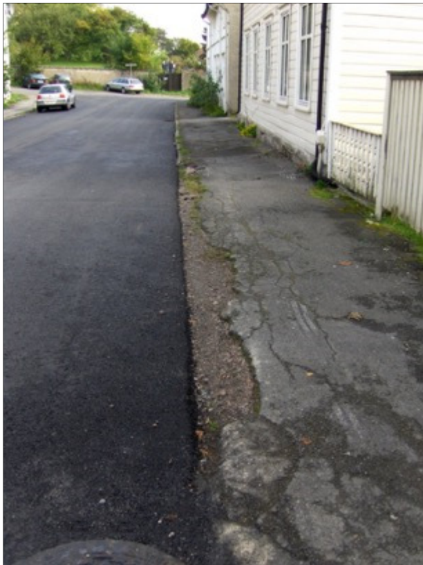
Manglende prioritering av gående ved dekkelegging.
