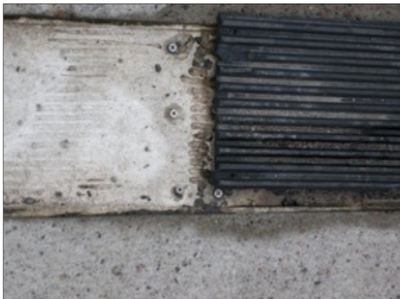
Skadd ledelinje i betongdekke.
